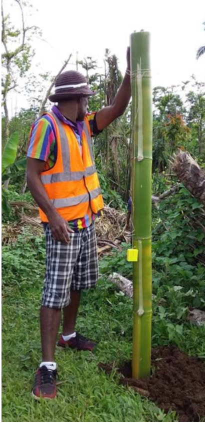
الشكل 15: محطة غسل يدين جديدة من الخيزران يتم غرسها في الأرض. حقوق الصورة: مؤسسة الرؤيا العالمية الدولية - فانواتو
