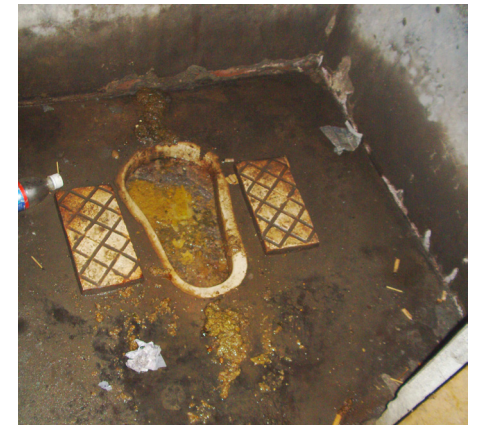
Latrine à fosse qui est pleine dans le village de Syedpur au Bangladesh. Photo : Suzanne Hanchett.
