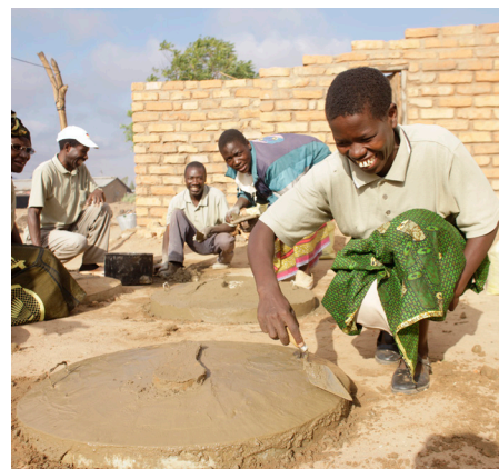
Elifa Mwaungulu construindo uma placa para o chão de uma latrina, aldeia de Chikompulazi, Mzuzu, Malawi. Fotografia: WaterAid / Layton Thompson
