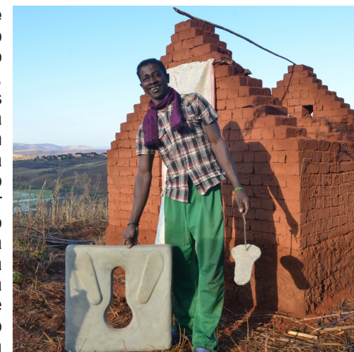
Impulsionador fazendo um chão de latrina, aldeia de Chikompulazi, Mzuzu, Malawi. Fotografia: WaterAid / Ernest Randriarimalala.
