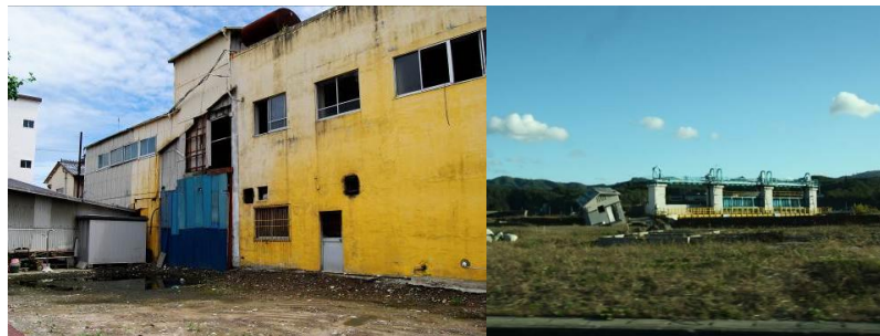
Figure 1-2 Post Earth quake image from Fukushima Prefecture. Sources: Cristina Pusceddu, Politecnico di Milano; Marco Imperadori, Politecnico di Milano.
